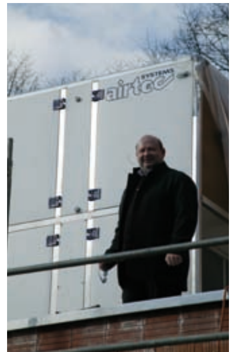
Manfred Langner zu Besuch auf der Baustelle: Der Greifswalder Gasthof zur Sonne soll im Frühjahr eröffnet werden, für saubere Luft ist bereits gesorgt.
